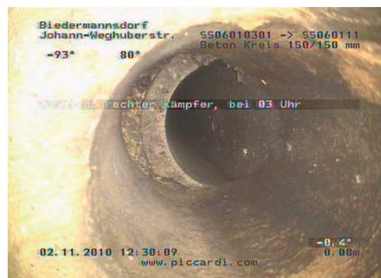
Bild des Kameraroboters im Zuge einer Kanalbefahrung. Der Leitungsversatz ist deutlich erkennbar.
